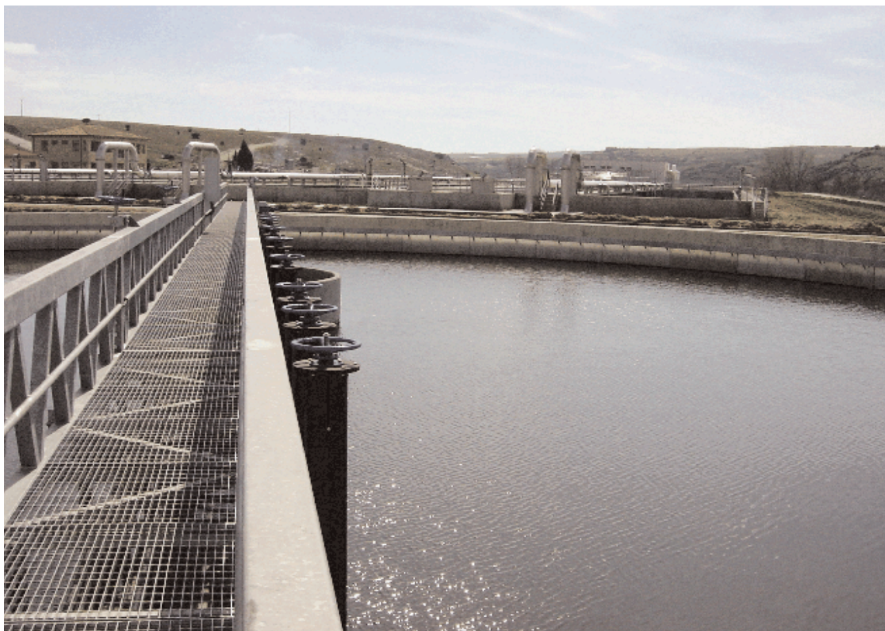
Depuradora de aguas residuales. Salamanca
